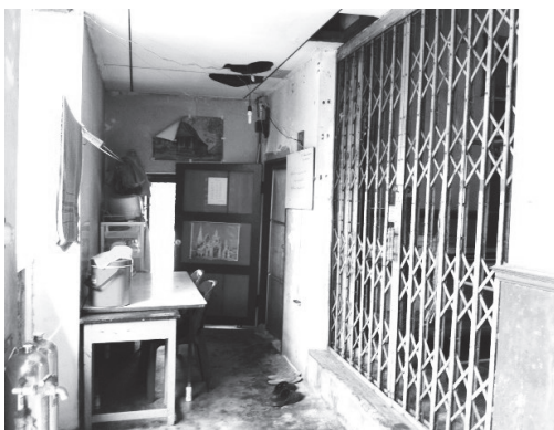
ภาพที่ 16 ภาพทางเดินและประตูเหล็กก่อนการบูรณะ
