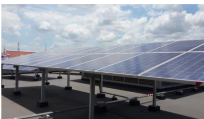
ติดตั้งบนดาดฟ้าอาคาร
