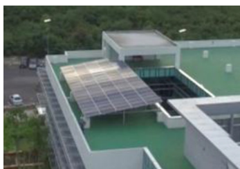
ติดตั้งบนดาดฟ้าอาคาร
