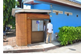
มีร่องรอยน้ำกัดขวางทางเข้าห้องน้ำ คนพิการ
