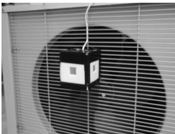
รูปที่ 9 การวัดอุณหภูมิจากเครื่องระบายความร้อน
