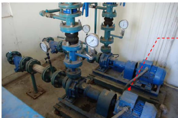
รูปที่ 1 อุปกรณ์เครื่องปั้มน้ำประจำอาคาร
