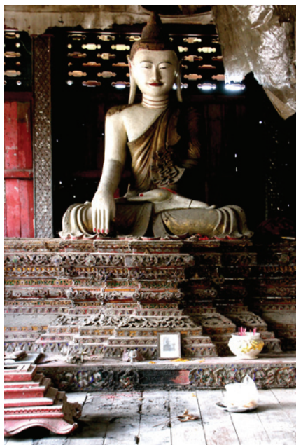
ภาพที่ 12 สภาพพื้นด้านหน้า พระประธานที่ถูกเพลิงไหม้
