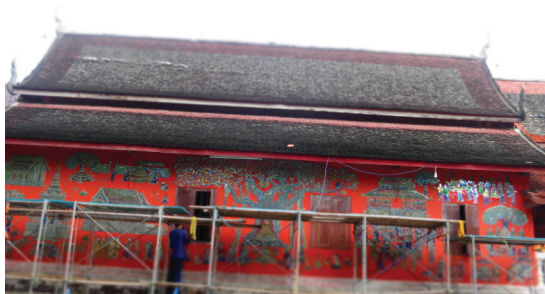
ภาพที่ 28 ภาพการทาสีพื้นตกแต่งเก็บรายละเอียดให้ทั่วทั้งผนัง (บันทึกภาพ 25 ต.ค. 56)
