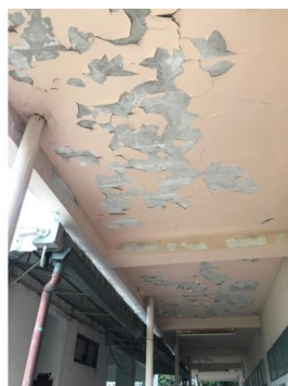
O ฝ้าเพดานหลุดร่อนและน้ำรั่วซึม
