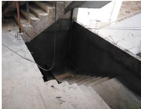
ภาพที่ 3 บันไดถาวรที่ยังไม่ได้ติดตั้งราวกันตก
