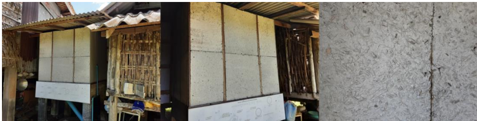
ภาพที่ 4 แผ่นผนังไยซีเมนต์ บ้านคุณอุบล บุญรัตน์
