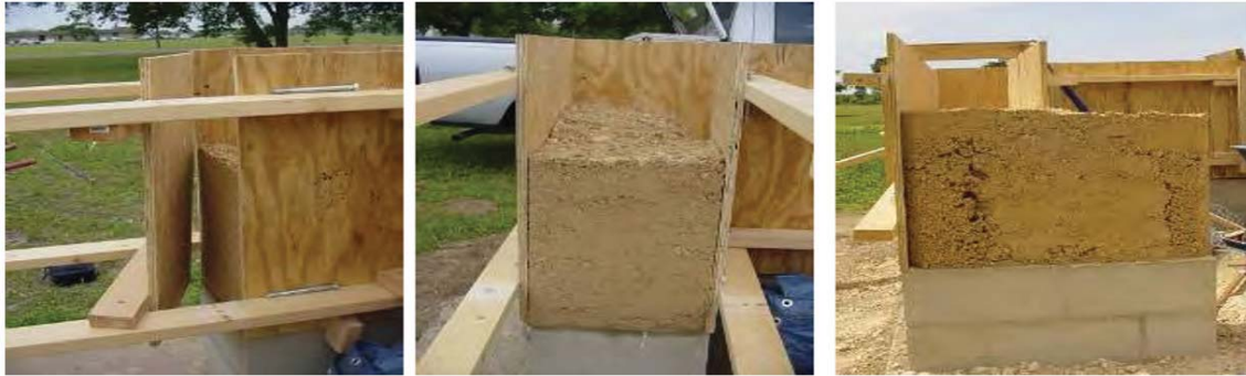
ภาพที่ 1 วิธีการสร้างอาคารด้วยเทคนิคดินอัด ที่มา: Richard Burt (2005)
