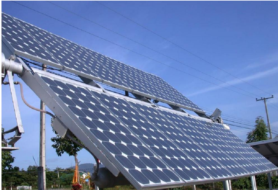
ภาพที่ 1 เซลล์แสงอาทิตย์ที่ติดตั้งบนอาคารสำนักงาน (ชาย ชิวเกียรติ และชนานัญ บัวเขียว, 2543)
