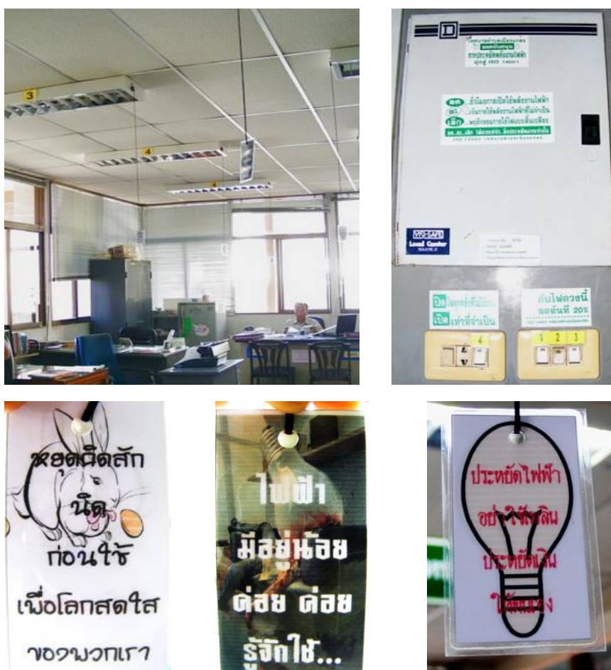
ภาพที่ 3 การนำสวิทช์ปิด-เปิดมาติดตั้งเพื่อช่วยในการประหยัดพลังงานไฟฟ้า และสติ๊กเกอร์รณรงค์ลดการใช้พลังงาน และป้ายคำขวัญประหยัดพลังงาน
